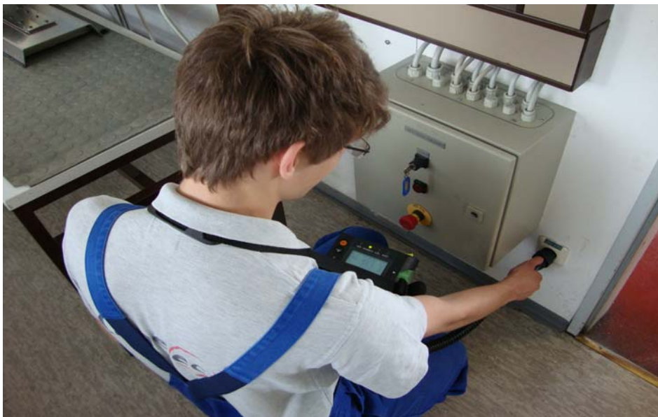
Messung an einem Unterverteiler
